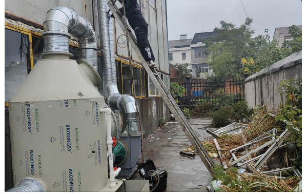
有组织排气筒出口
